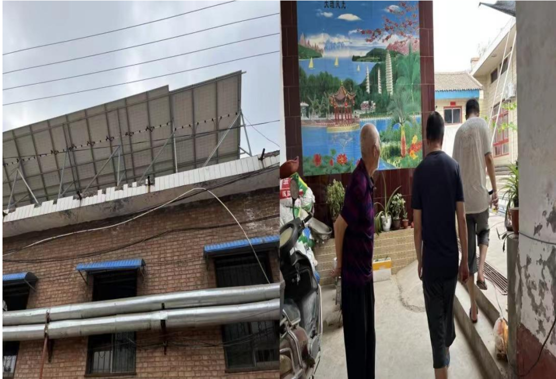
图 23 临汾大邓乡工业余热+屋顶光伏
