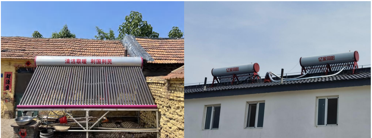
图/ 无产品标识的太阳能设备 村民多次维修保温的太阳能设备
