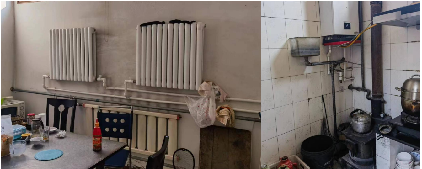
图/ 暖气片安装在餐厅 未对接的新老管线
